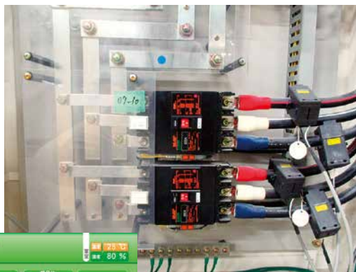
配電盤に取り付けた計測器
