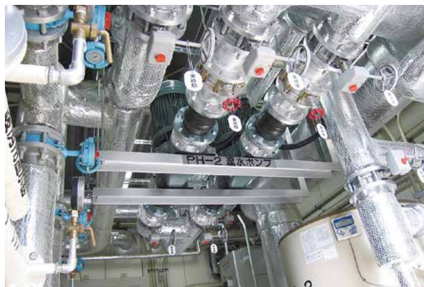
御殿場工場のボイラー
