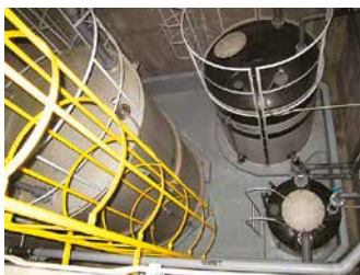
御殿場工場の廃液タンク
